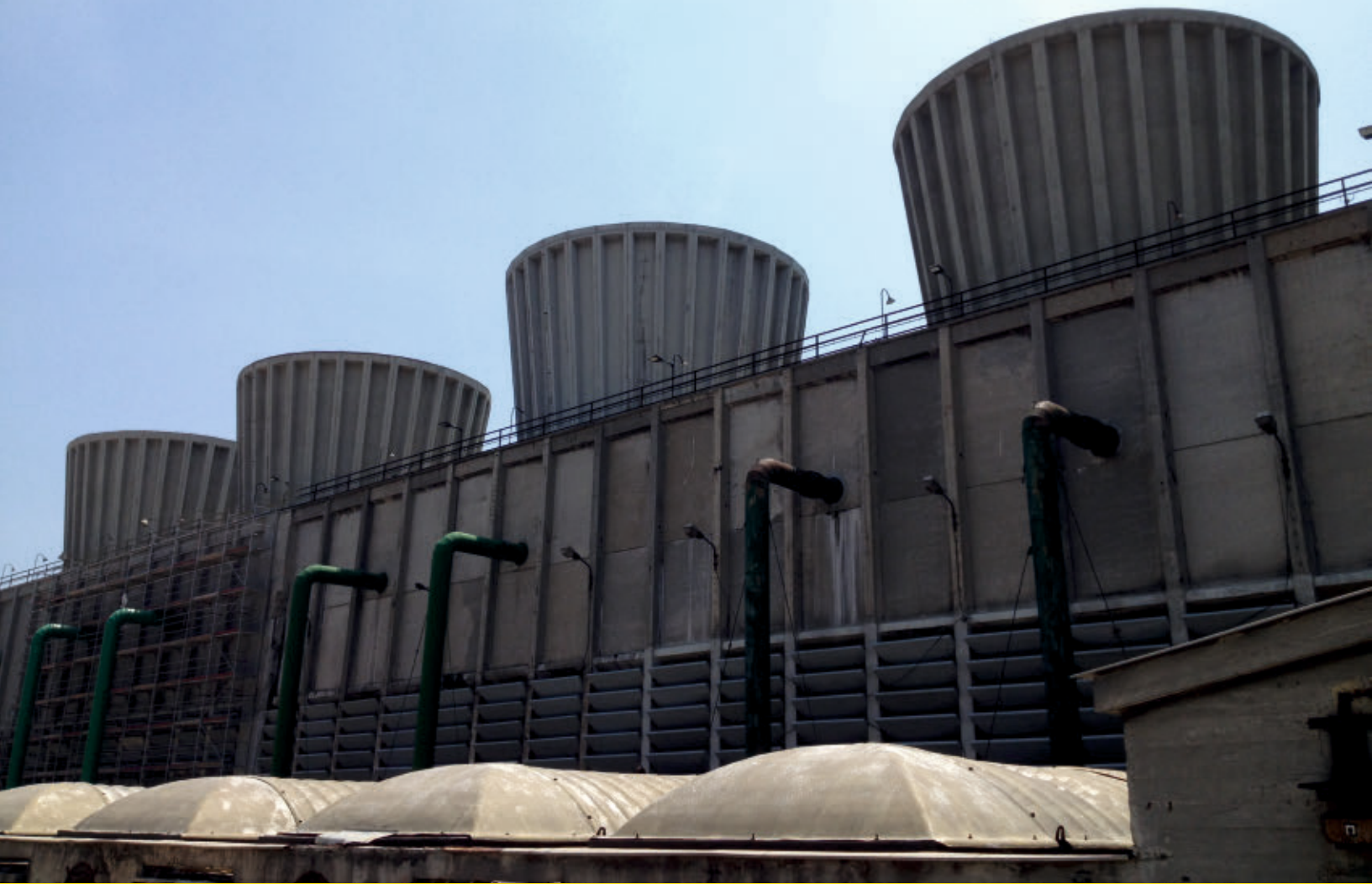
Nitrogénművek Zrt. - Pétfürdő, Hősök tere 14. CT1 hűtőtornyok
